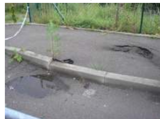
Événement d'effondrement en 2014
