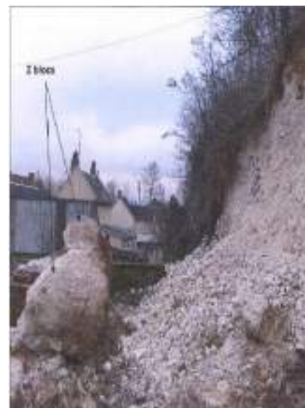
Événement chute de blocs/éboulements de 2008 – rue Alexandre Vasseur
